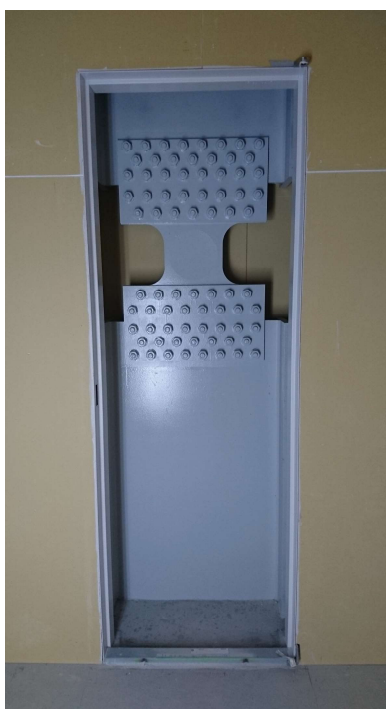
ダンパー点検用窓
